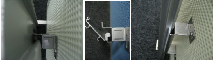
部屋(ケーブルスペース)
